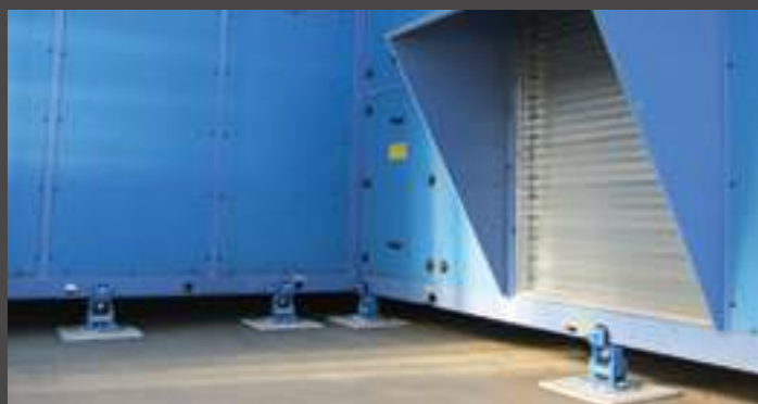
unità trattamento aria air handling units
