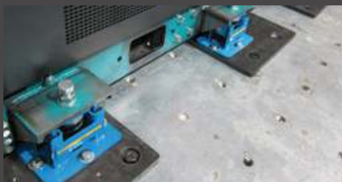
ups - unità crac ups - crac units
